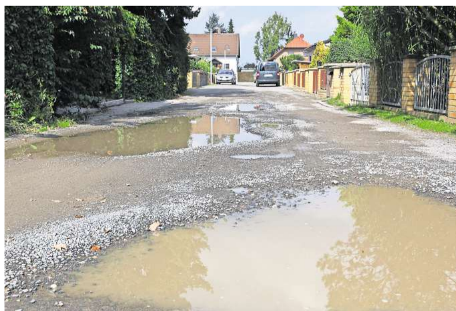
Egal zu welcher Jahreszeit, seit Jahren befindet sich die Anliegerstraße Hasenheide in Dölzig in einem desolaten Zustand.
